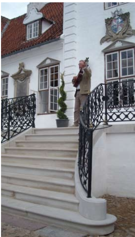
Fotos fra indvielsen af den restaurerede sandstenstrappe, balkon, og smedejernsgitter. Foto: Erik Einar Holms Tegnstue
