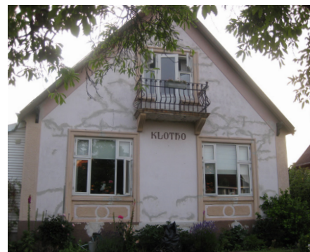
Revner i pudsen kan reparerer ved at opkradse revnen til ca. 5-10 mm, evt. med maskinværktøj, og derefter fuge revnerne ud med en mørtel lig den oprindelige, men svagere i styrke. Det vil sige uden Portlandcement-tilslag. Der skal forvandes godt, og ydersiden skal sammenpresses og glattes omhyggeligt.
