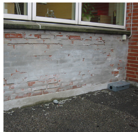
En alt for cementskold tyndpuds (fjelsning) på helt nyt murværk bevirker, at fugten ikke kan komme ud gennem pudsens og derfor først presser sig ud gennem fugerne og derefter skyder skaller af murstenene.
