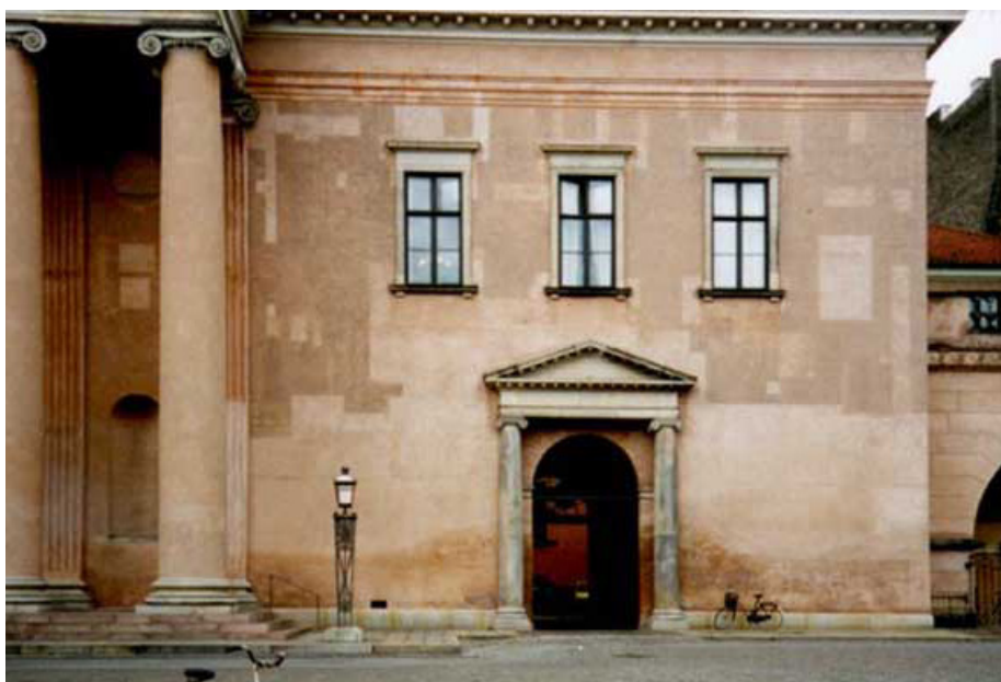
Skadet og forvitret facadepuds bør reparerer partielt, dvs. at man kun udskifter og nypudser de områder, der er løst eller skadet, men lader de andre områder være. Der beskæres efter rette linjer. Derudover skal man forsøge at ramme den oprindelige farve bedst muligt, så reparationerne ikke syner så meget.
