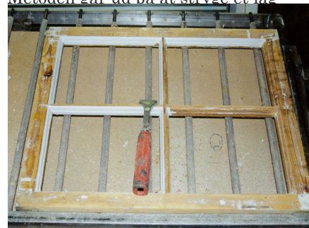
Vådafskræbning af en vinduesramme – uden varme. Varmen ødelægger træet ved at svede olie- og harpiksstoffer uf af veddet.
