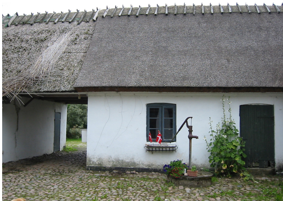
På kæppetækkede, bundne tage – det slidte stråtag til venstre - vil kæppene blive mere eller mindre synlige allerede 3-10 år, inden det skal udskiftes. Hvis kæppene er bundne med galvaniserede jerntråd, vil de kunne holde en del år, indtil kæppene rådner
