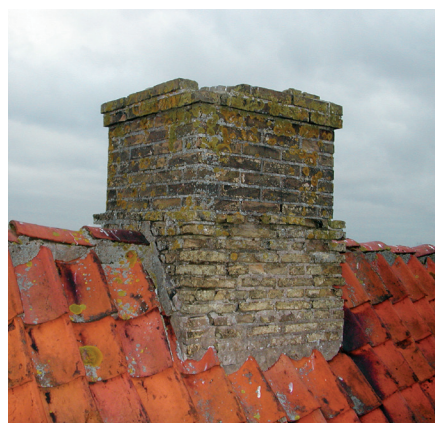
Manglende vedligeholdelse har resulteret i udvaskede fuger og løse sten. Skorstenens afdækning bør genetableres, og gamle antennebeslag bør fjernes.
