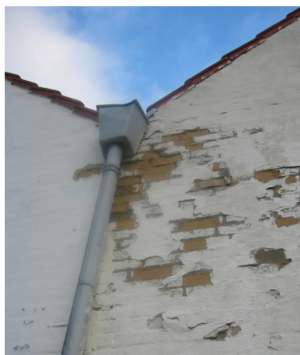
En utæt tagrende eller et utæt nedløbsrør afslører sig meget hurtigt med våde eller misfarvede pletter på facaden. Plasticmalingen holder yderligere på fugten, så murstenene frostsprænger.
