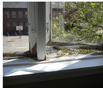
På et vindue skal malingen naturligvis være intakt udvendigt, da træet ellers vil blive vådt i regnvejr. Sker det, udvider træet sig en smule, hvorefter malingen også begynder at skalle af indvendigt. Hvis der oven i købet løber kondensfugt ned af ruderne indvendigt, går nedbrydningen pludselig stærkt.
