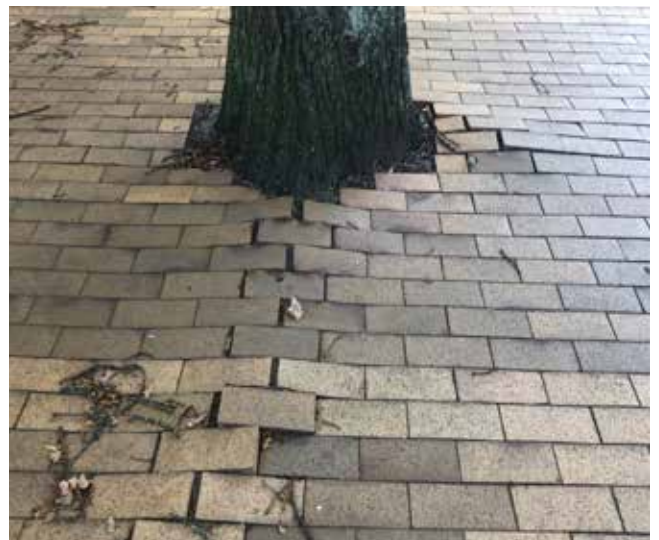
Opbrudt fortov ved træ
