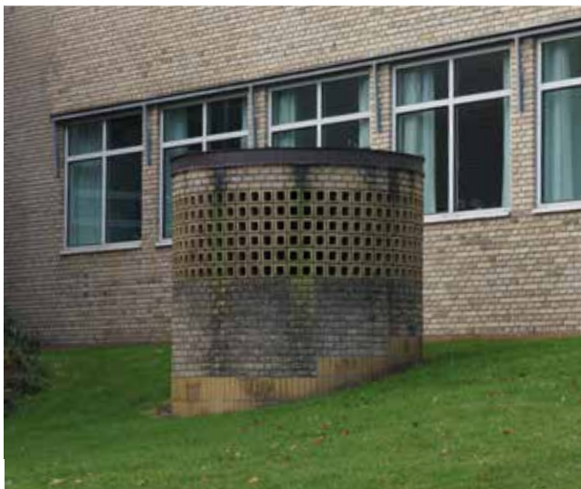
Udluftningsanlæg i Vennelystparken
