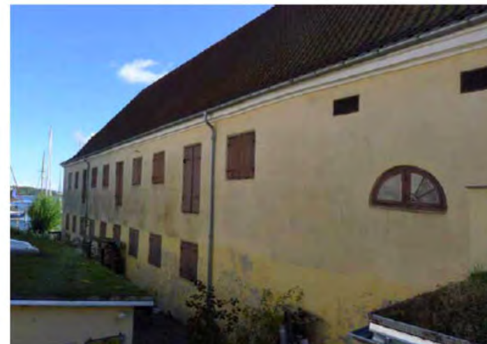
Facade mod nord: Lunettevinde ses til højre og markerer den del, hvor korntringsanlægget er placeret.
