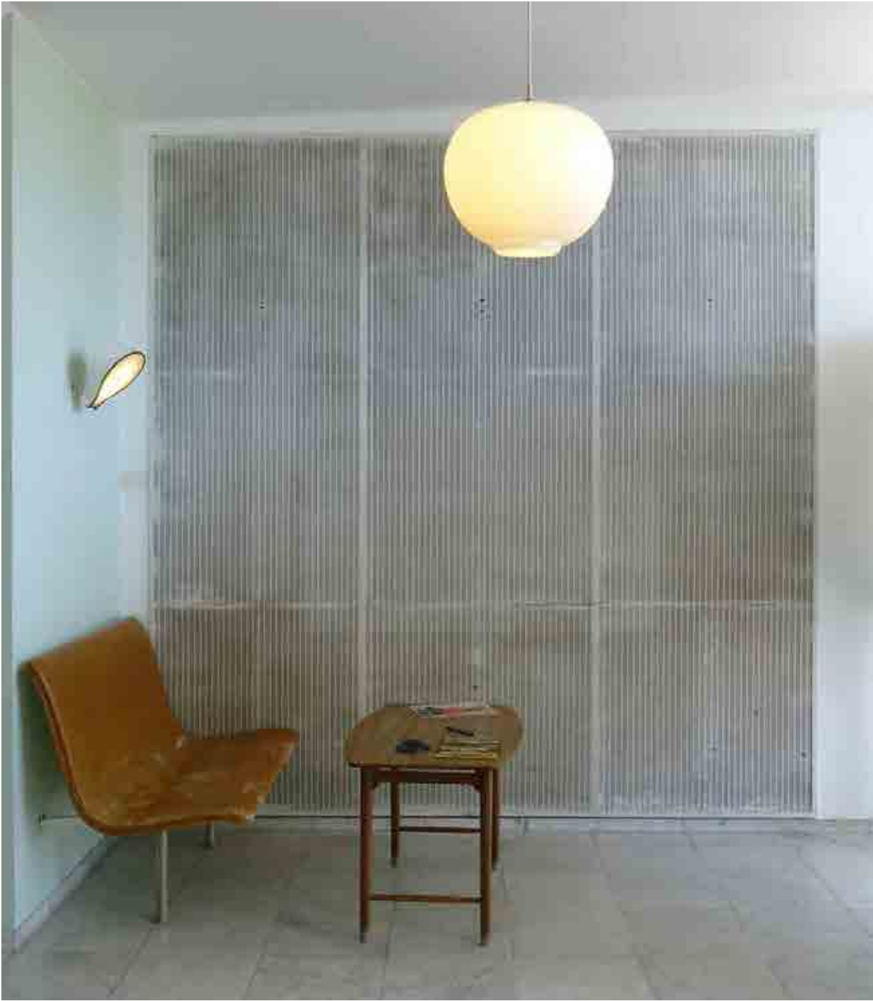
De store radiatorer på hver etage i hall'en er indbygget bag perforerede metalriste.
