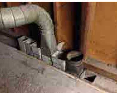
Indbyggede aftrækskanaler for ventilation.
