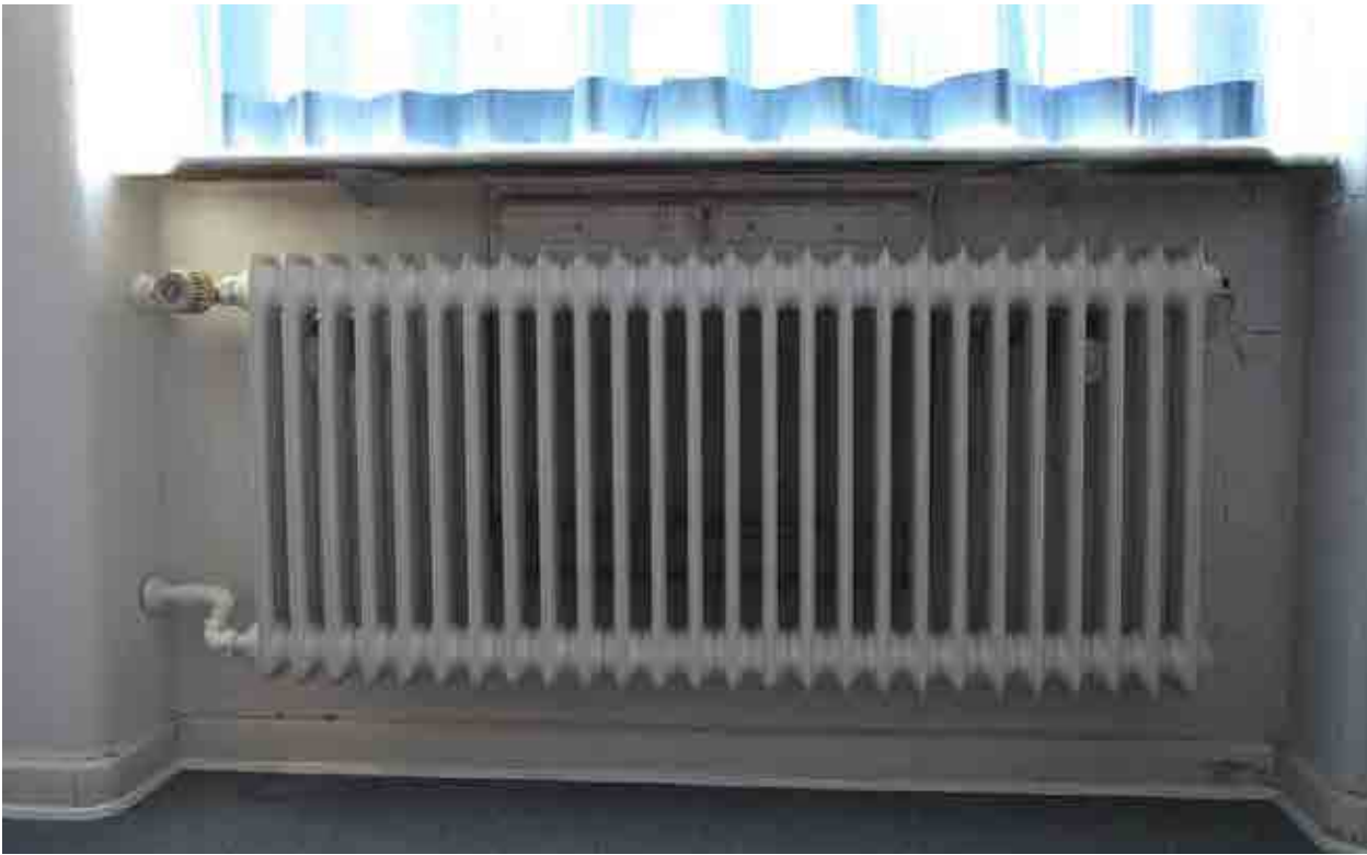
Oprindelig radiator i kontor. Vandrette linjer: vinduer, vinduesplade, rørføring, radiator, fodpaneler.
