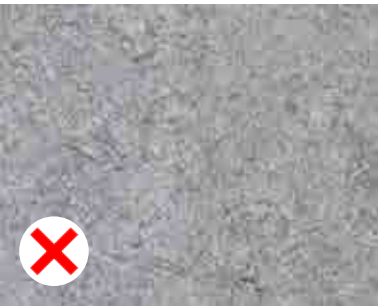
Marmoreret gråblå linoleum skal fjernes.
