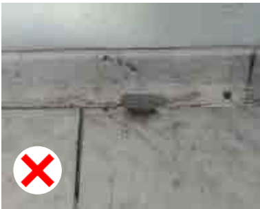
Marmorgulve må ikke beskadiges.
