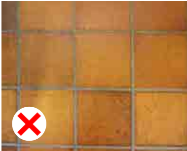
Brunrøde klinker skal fjernes.
