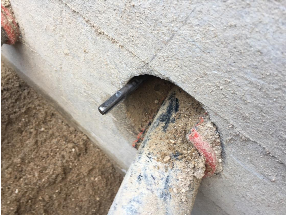
Foto 3. Der er ikke udført en tætning mod ydersiden.
