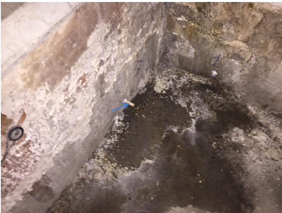
Foto 6. Rør nr. 5 (pil) og rør nr. 1. Foto fra 1.3.2017, hvor der fortsat løb vand ud af rør nr. 5.
