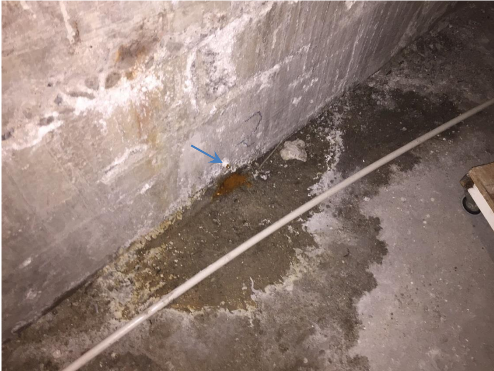
Foto 5. Rør nr. 2. Foto fra 1.3.2017, hvor der fortsat løb vand ud af røret.
