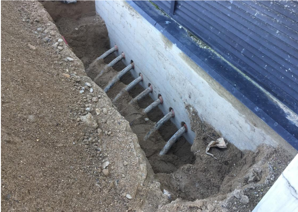
Foto 1. Rørgennemføringer på vestgavl. Udvendigt.
