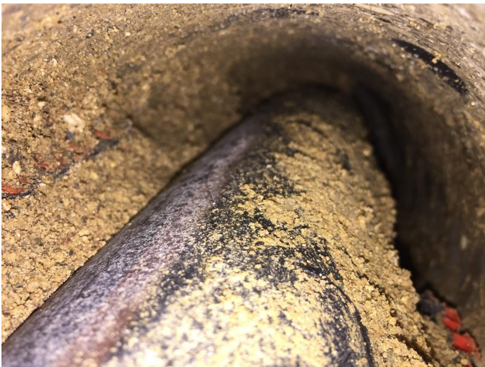
Foto 4. Ind langs rør i hullet ses ingen tætningsmateriale.
