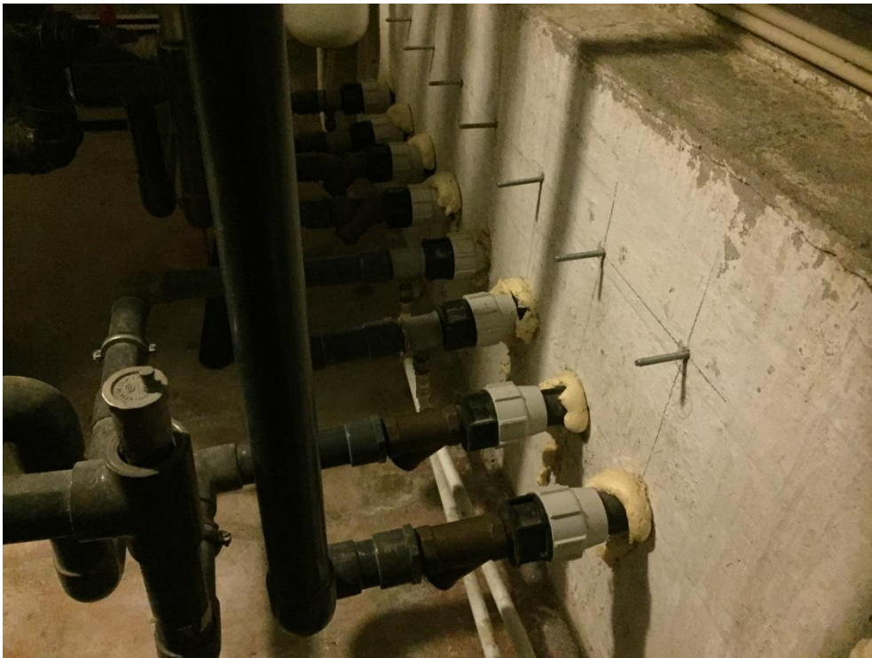
Foto 2. Rørgennemføringer på vestgavl. Indvendigt.
