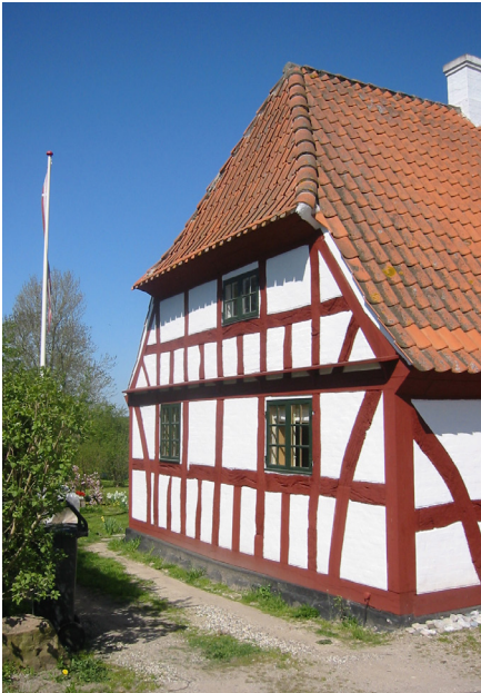
Repareret bindingsværkshus overfladebehandlet med rødokker limfarve (kaseinfarve) på tømmeret og hvidtekalk på de pudsede (luftkalkmørtel) tavl.
