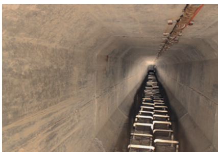
16. Reserveindsugningsskakt med trin, så man i en nødsituation kan klatre op i det fri. Foto: Karsten Pedersen.
