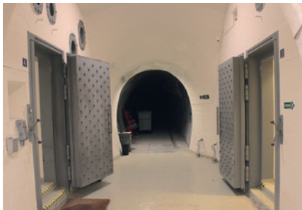
10. Knudepunkt med 2½ tons tunge betonarmerede ståldøre, der er bygget til at kunne tåle trykbølgen fra en atomeksplosion. Foto: Karsten Pedersen.
