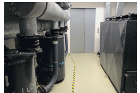
15. Ventilationsrum, hvor luften kan renses for kemiske, biologiske eller atomare kampstoffer. Foto: Karsten Pedersen.
