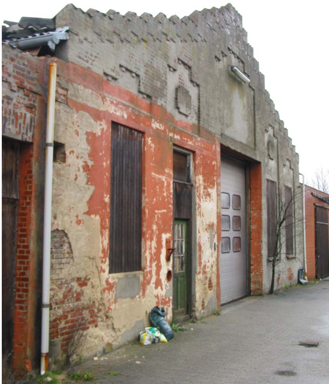
Kamtakket gavlmotiv fra den ældre del af fabriksanlægget, som nu ses i lettere forfalden tilstand
